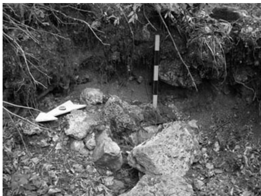
Рис. 10. Разрушенные стены храма.
